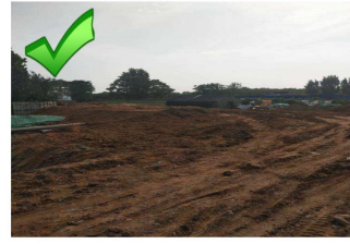
施工场地裸土
